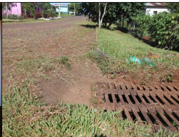
FOTO 04 – Escoamento da água
