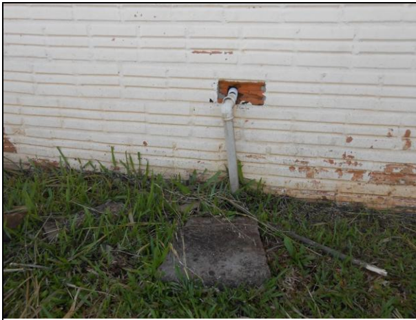
FOTO 01 – Caixa de Gordura
