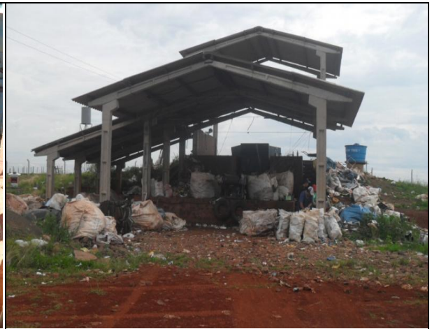
FOTO 02 – Galpão de Triagem
