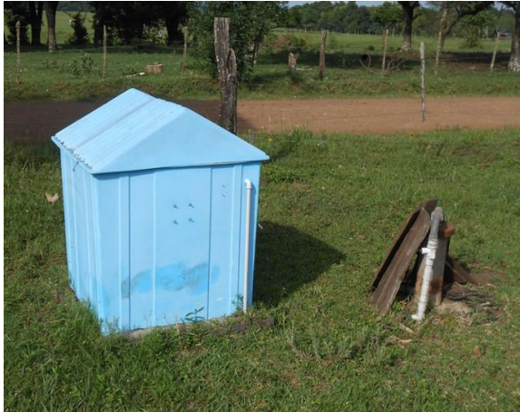
Barra do Retiel/Captação e Tratamento
