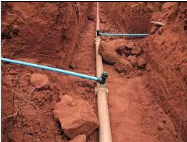
FOTO 03 – Rede de Distribuição
